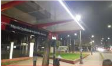
Sistema de iluminación solar
